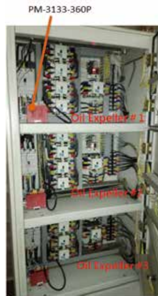
圖3. PM-3133-360P智能電錶安裝位置
